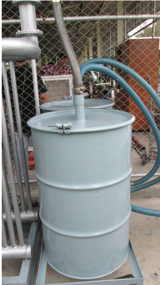
รูปที่ 3.13 อุปกรณ์ประกอบระบบผลิตไฟฟ้าด้วยเครื่องยนต์ชีวมวล: ชุดพักแก๊ส
