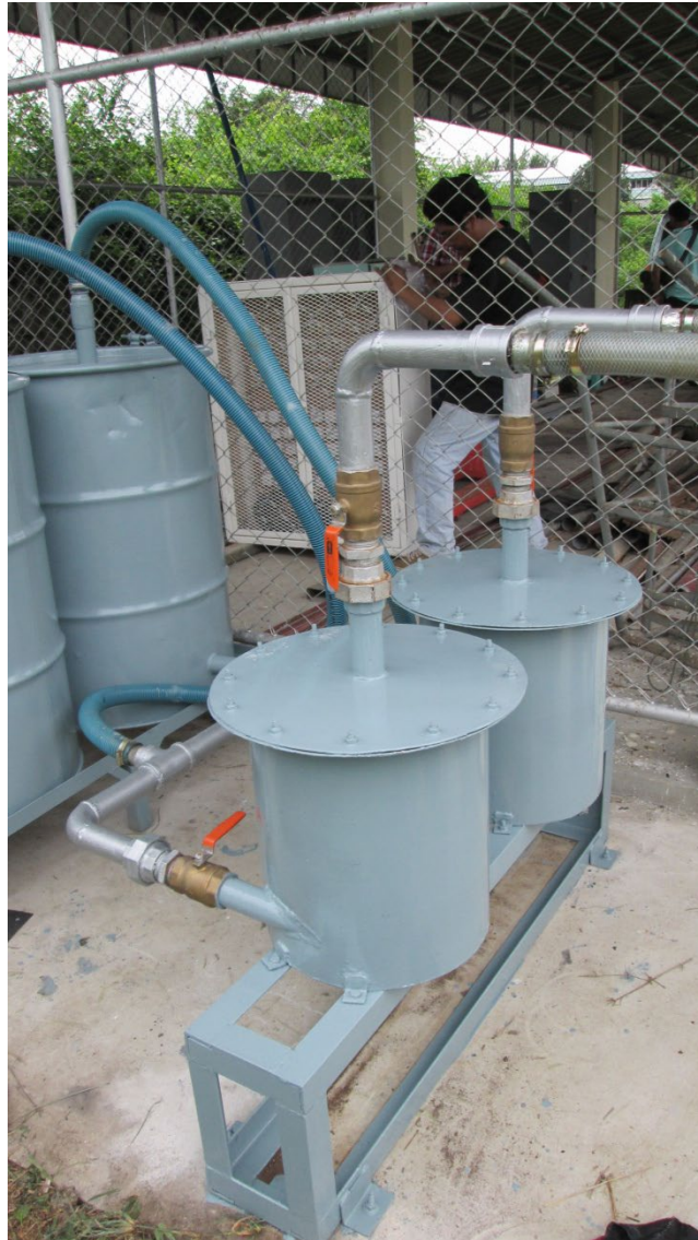
รูปที่ 3.14 อุปกรณ์ประกอบระบบผลิตไฟฟ้าด้วยเครื่องยนต์ชีวมวล: ชุดกรองแก๊ส
