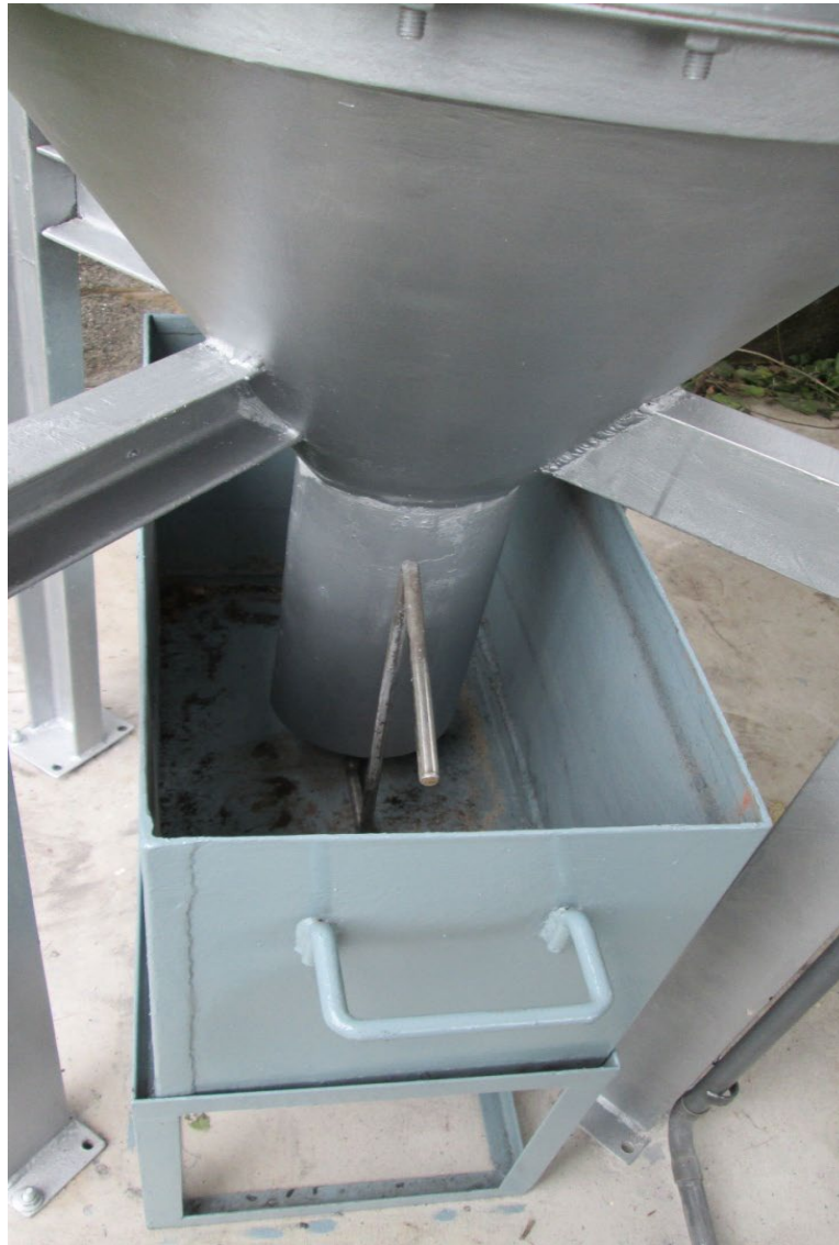
รูปที่ 3.10 อุปกรณ์ประกอบระบบผลิตไฟฟ้าด้วยเครื่องยนต์ชีวมวล: ที่ดักเถ้า
