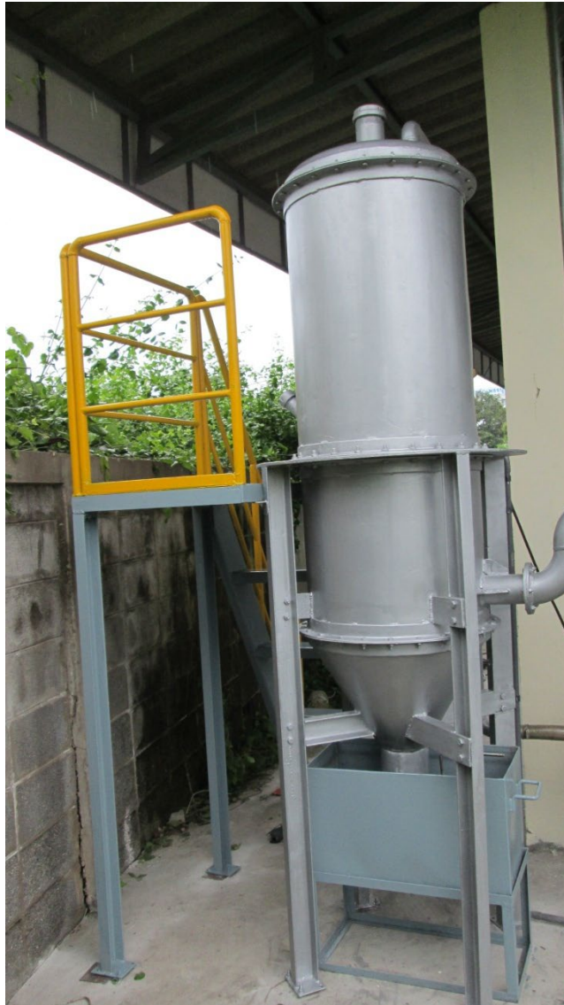
รูปที่ 3.7 อุปกรณ์ประกอบระบบผลิตไฟฟ้าด้วยเครื่องยนต์ชีวมวล: แก๊สซิไฟเออร์ชนิดเบดคงที่ เปลวไฟไหลลง
