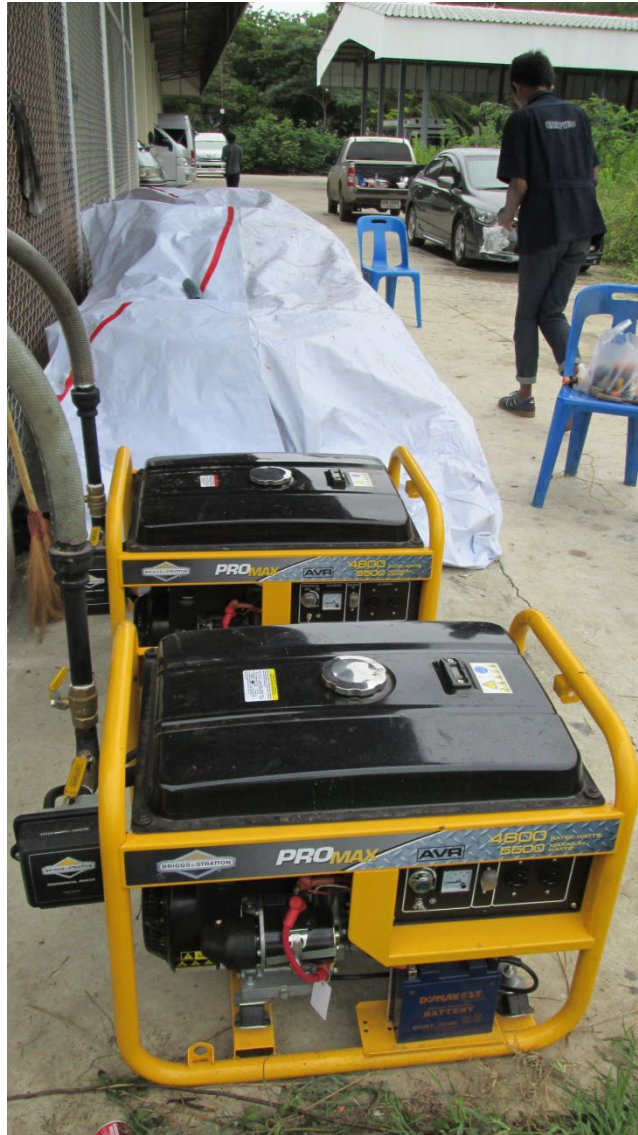
รูปที่ 3.15 อุปกรณ์ประกอบระบบผลิตไฟฟ้าด้วยเครื่องยนต์ชีวมวล: เครื่องยนต์พร้อม เครื่องปั่นไฟฟ้า
