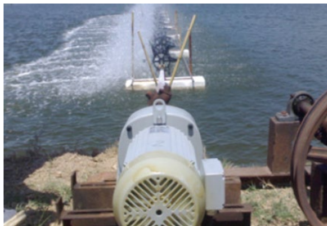
รูปที่ 2.1 แสดงการนำมอเตอร์เหนี่ยวนำในการบำบัดน้ำเสียสำหรับฟาร์มกุ้ง
