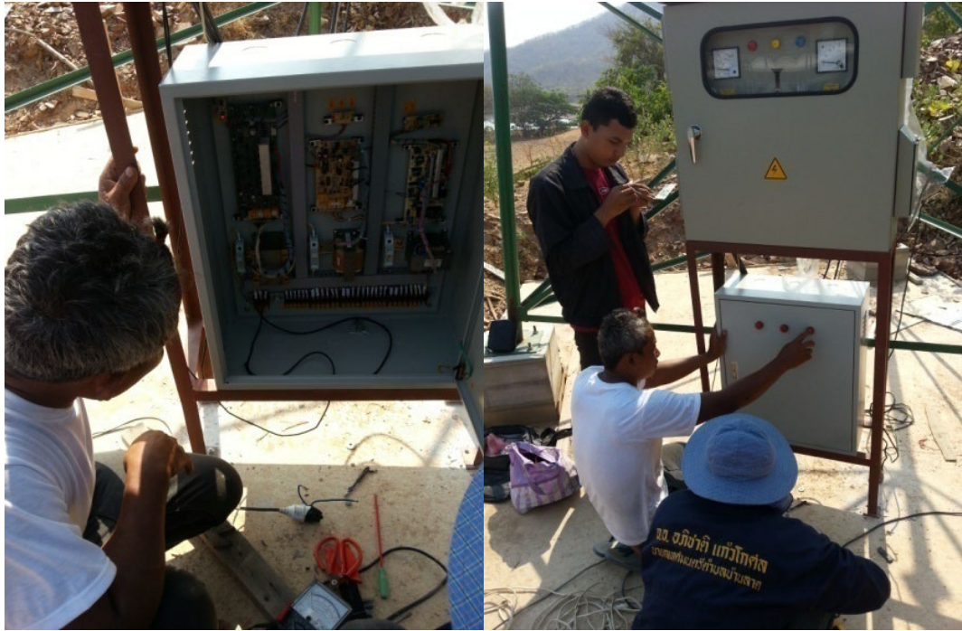
รูปที่ 4-6 ชุดควบคุมและป้องกันการผลิตไฟฟ้าของเครื่องกำเนิดไฟฟ้าเหนี่ยวนำ
