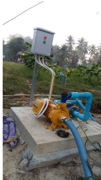
ภาพที่ 5 การวางปั้มน้ำและอุปกรณ์ส่งสัญญาณบนเครื่องข่ายไร้สาย เพื่อจ่ายน้ำในสวนกล้วยหอมทอง
