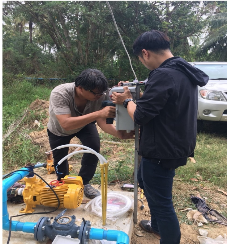
ภาคผนวก 14 แสดงการติดตั้งอุปกรณ์ควบคุมปั้มน้ำ
