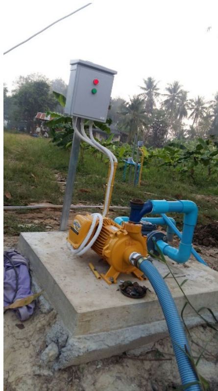
ภาคผนวก 15 แสดงปั้มน้ำเมื่อติดตั้งเรียบร้อยแล้วพร้อมอุปกรณ์ส่งสัญญาณ WiFi
