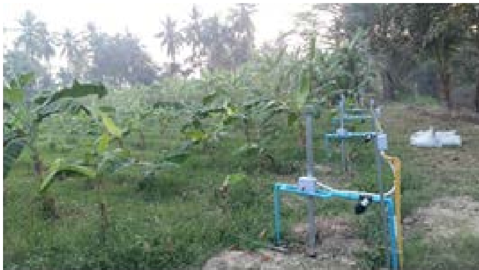
ภาคผนวก 16 แสดงวาล์วน้ำ 6 จุด เมื่อติดตั้งเรียบร้อยแล้วพร้อมอุปกรณ์ส่งสัญญาณ WiFi
