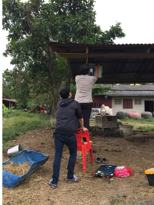
ภาคผนวก 9 แสดงการติดตั้งอุปกรณ์ควบคุม
