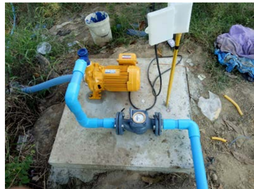
ภาพที่ 3.12 ปั้มน้ำและมาตรวัดน้ำ
