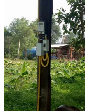
ภาพที่ 3.16 ตำแหน่งบนเสาของการติดตั้งมิเตอร์ไฟฟ้า
