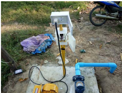
ภาพที่ 3.11 สวิตช์ปิดเปิดปั้มน้ำ
