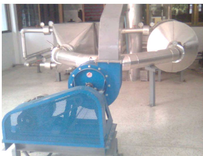
ภาพที่ 3.6 การติดตั้งเครื่องดูดความร้อนทิ้งหลังจากที่ถ่ายโอนความร้อนให้แก่อุปกรณ์อุ่นน้ำป้อน
