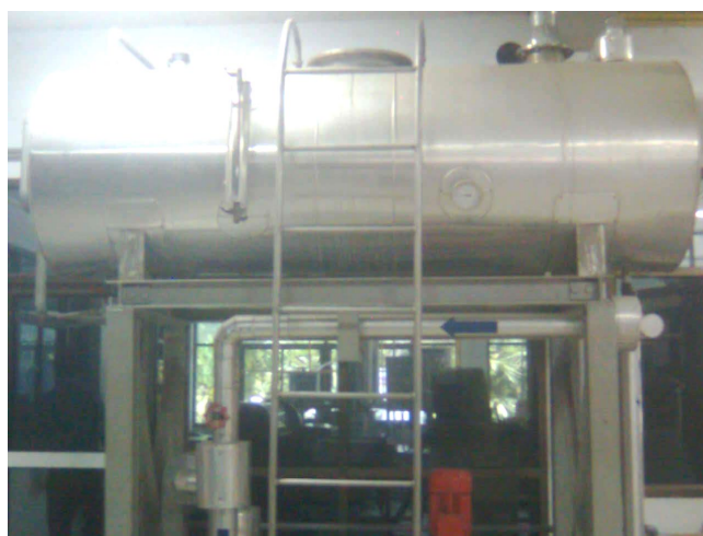
ภาพที่ 3.7 ระบบถังน้ำป้อนให้แก่อุปกรณ์อุ่นน้ำป้อน
